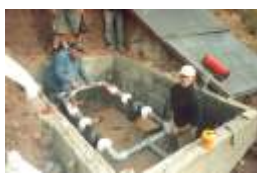
CAJA DE VÁLVULAS
