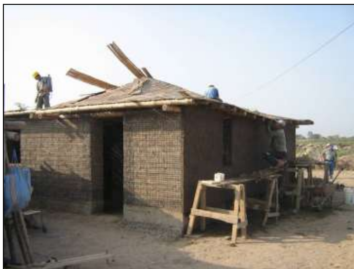
Foto: Modelo de vivienda de adobe reforzado con geomalla ejecutado por la PUCP con fondos de FORSUR
